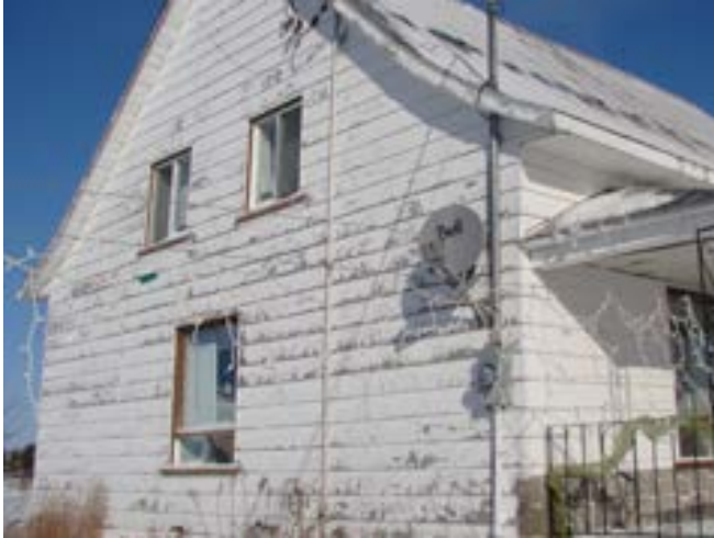
Figure 7 : Revêtement de massonite en mauvais état à retirer.
