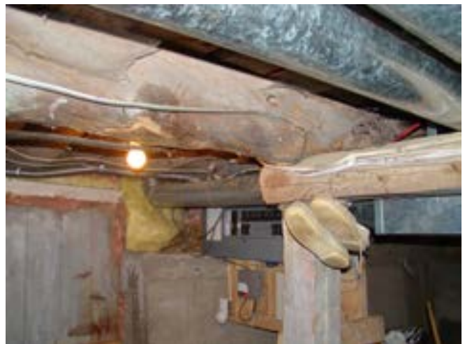
Figure 6 : La structure du plancher est composée de grumes généralement en bon état. Mais leur support est déficient à plusieurs endroits car certaines pièces ont été coupées.
