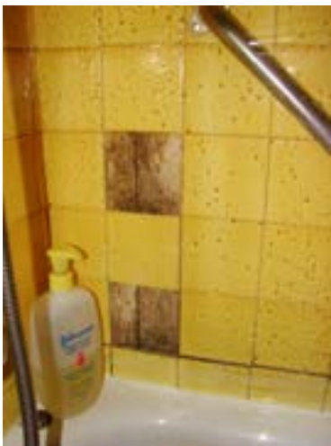
Figure 13 : Céramique autour du bain en très mauvais état.
