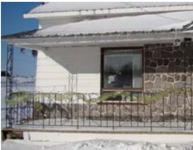
Figure 11 : Garde-corps et poteaux de galerie en fer forgé à remplacer.
