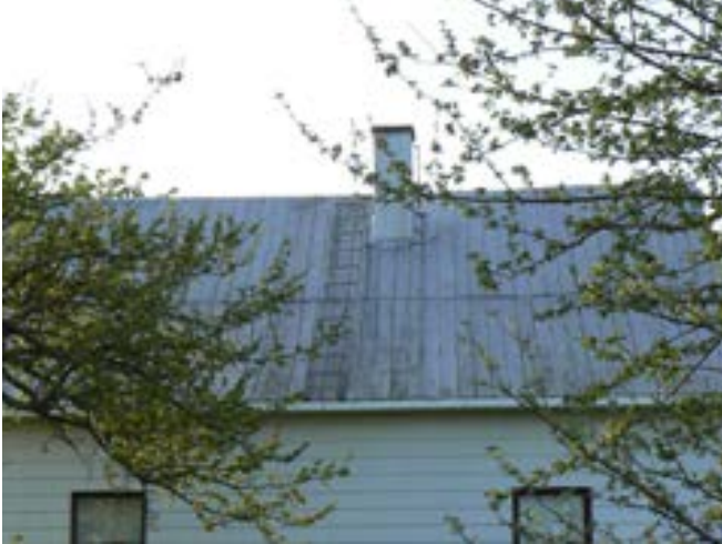
Figure 13: Toiture en tôle à grange à repeindre.
