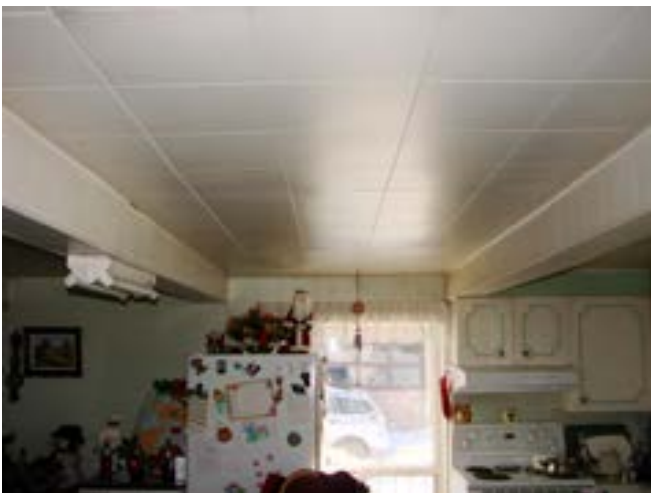
Figure 17: Préfini et carreaux de carton-fibre à retirer afin de mettre en valeur les finis originaux en bois de la maison.
