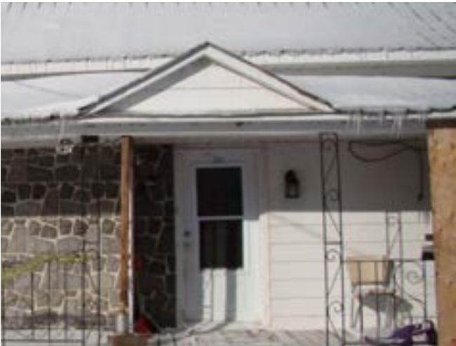
Figure 9 : Porte principale en acier à remplacer. Parement de pierre à enlever.
