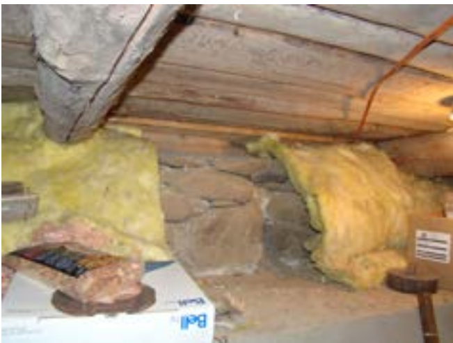
Figure 5 : Fondations de pierres pilées avec peu ou pas de mortier. Elles ont été excavées par la construction d'un mur de béton. Des traces d'efflorescence sont présentes dans les joins de maçonnerie.
