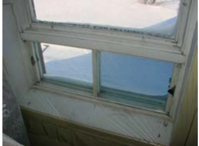
Figure 8 : Fenêtres en mauvais état à remplacer.
